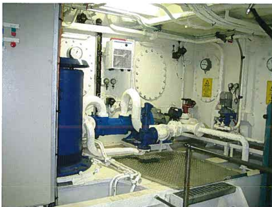
Figur 7 I dette området av maskinrommet kan kondensatpumpene plasseres
