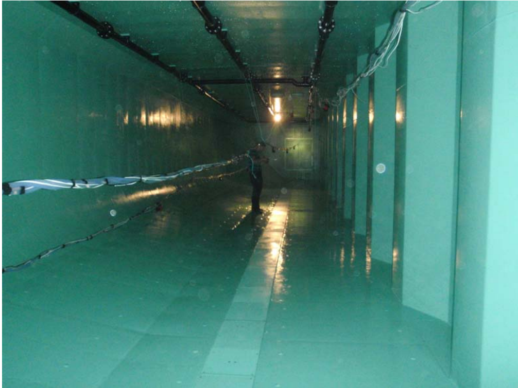
Bildet viser prøvetakingsystemet plassert i brønn. Tre linjer, plassert diagonalt i rommet med fem uttakspunkt.
