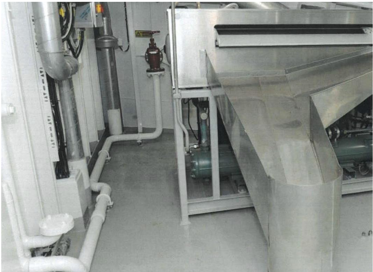
Ismaskin er plassert under dekk
